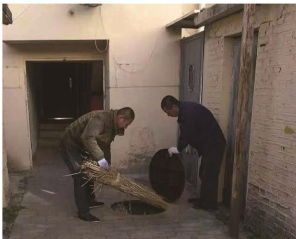
做好供水管设施防冻,保障低温天气用水
