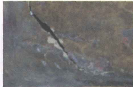
图3 壁画右下角的裂缝
