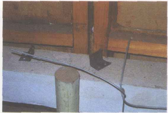
图 5 壁画固定件的松脱 Fig.5 Unstuck fixity
