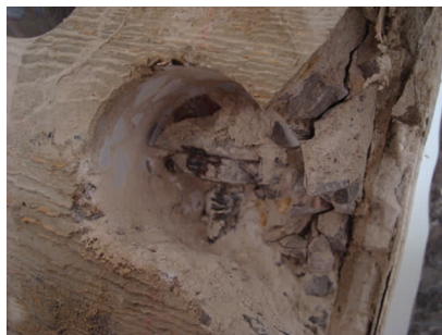
图3 混凝土构件内部钢筋锈蚀
