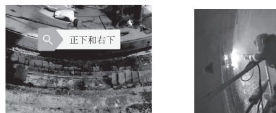
(a) 损坏情况
