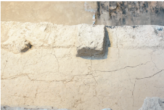
图4 二层台与坑壁裂缝
