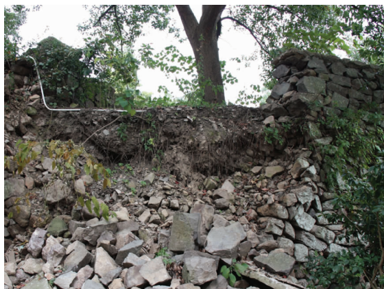
图4 樟树引起的城墙垮塌(东城门北侧)
