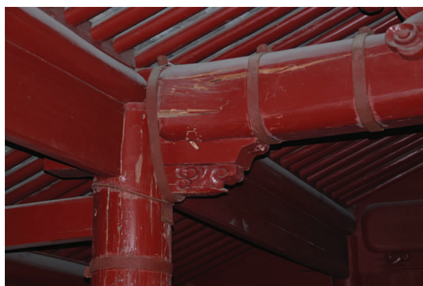
图4 后殿明间五架梁与后金柱断、开裂情况(细部)
