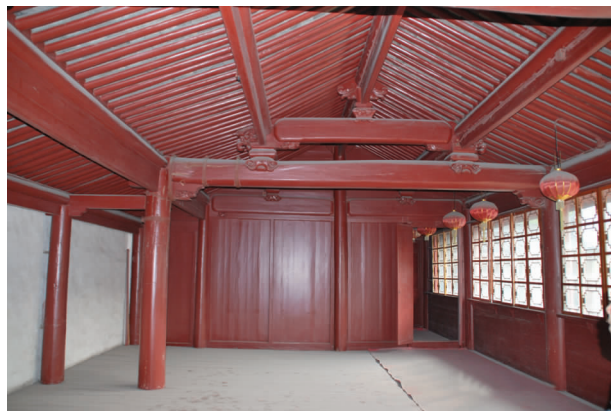
图3 后殿明间五架梁与后金柱断、开裂情况
