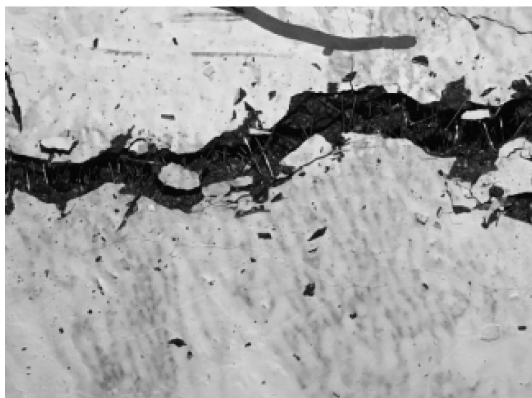
图 7 纯弯段破坏细节 Fig. 7 Detail of failure mode
