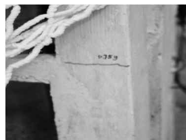
(c) 主楼二层剪力墙底端裂缝
