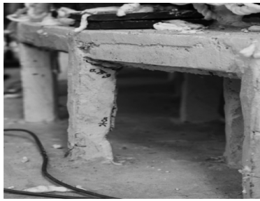
(d) 附楼I底层柱顶裂缝
