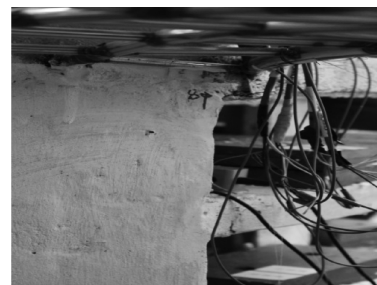
(a) 连廊下弦与附楼 I 连接处裂缝
