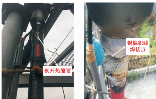
图 14 110 kV 某甲线#B 塔 A 相电缆终端
