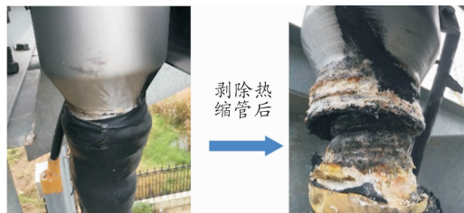
图 2 故障电缆终端
