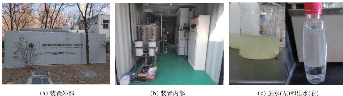
图 3 实验室废液降危减量一体化设备及其进、出水水样对比
