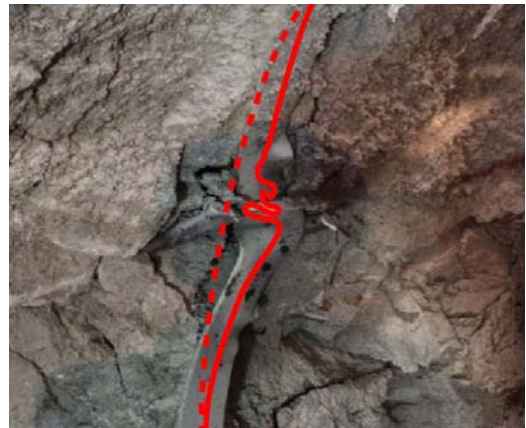
图 2 初期支护钢拱架扭曲变形
