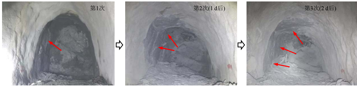
(b) 高应力驱动下隧洞围岩表层持续开裂破坏 图 1 高应力下地下洞室硬岩渐进开裂的现场观察实例
