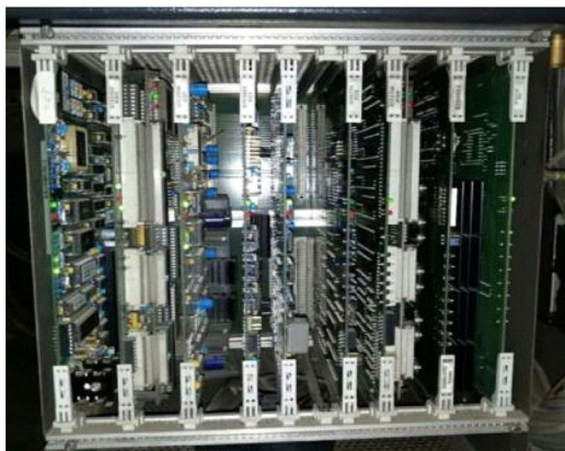
图 1 仪器电子机柜内电路板
