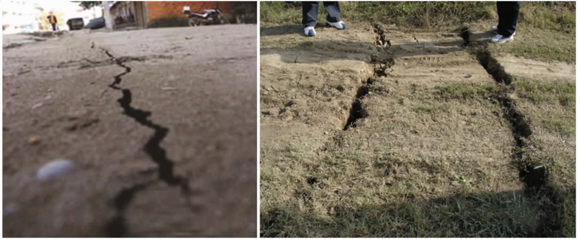
图 11 地震裂缝典型照片
