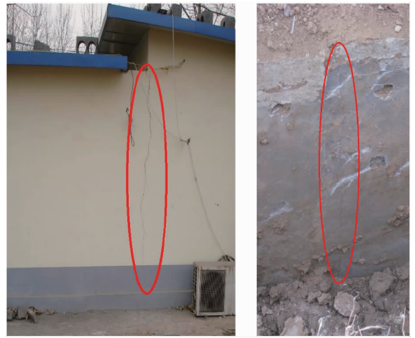
图5 断裂导致的小平房A(左侧、镜向西)和泥砌排水沟(右侧、镜向南东)出现裂缝
