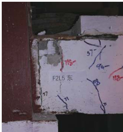
图 15 1/25加载位移角模型节点损伤情况
