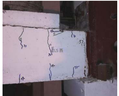
图 14 1/50加载位移角模型节点损伤情况
