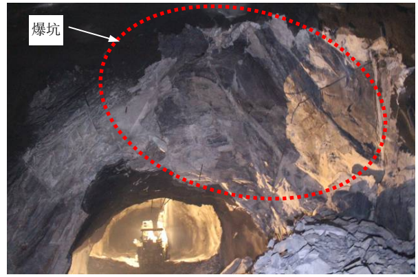
图 7 7#实验室拱顶及拱肩岩爆
