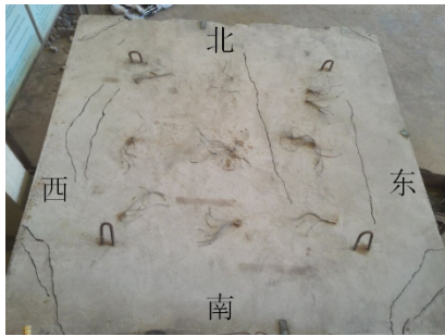
(a) 板顶裂缝实景图
