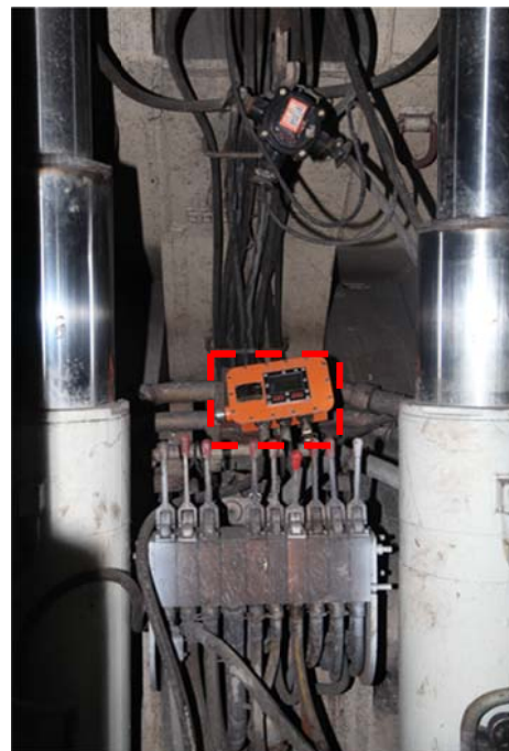
图 26 液压支架工作阻力监测设备
