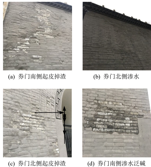
图 2 基座西侧外墙水害分布
