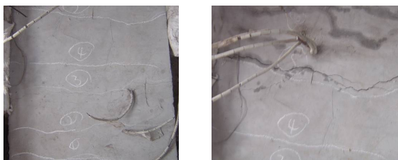
(a) 横向裂缝 (b) 主裂缝
