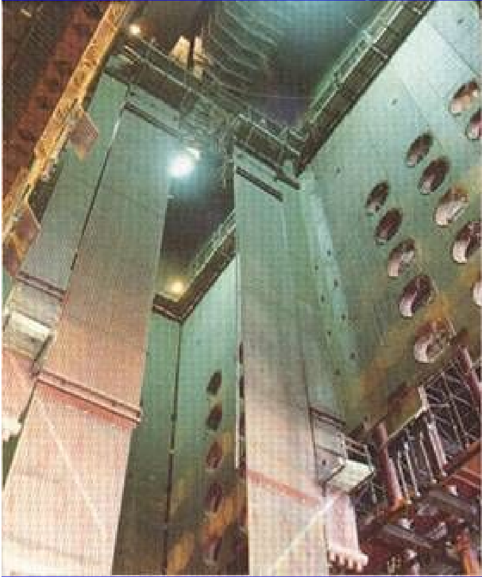
燃烧器安装位置
