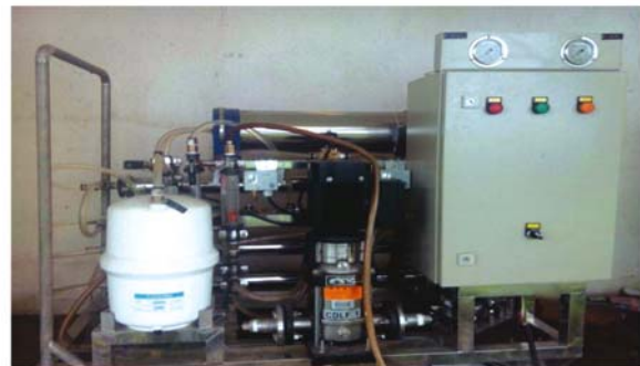
图 1 纳滤设备实物
