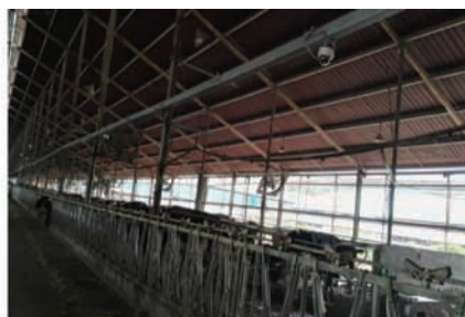
图 3 摄像头现场安装图
