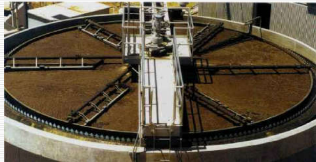
高效浅层气浮池 (DAF)
