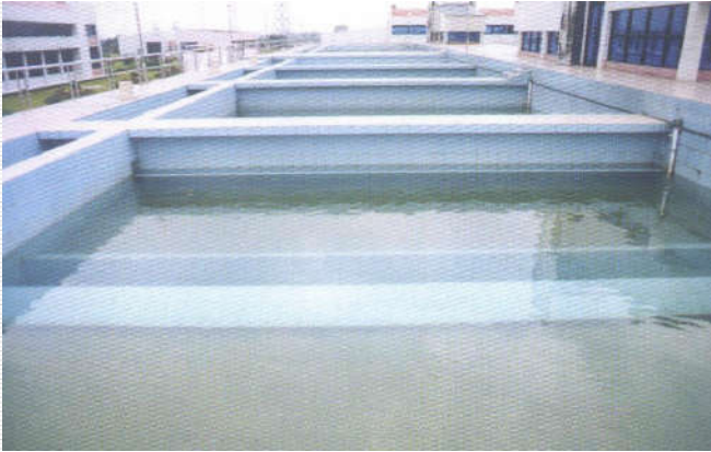
运行中的V形滤池
