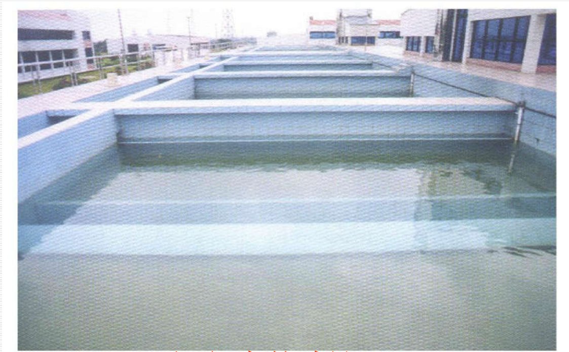
运行中的滤池
