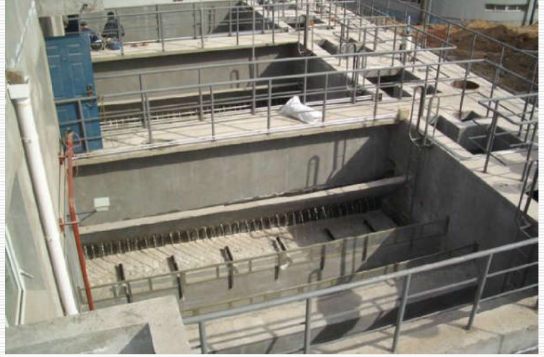
运行中的V形滤池
