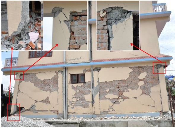
(a) Charikot 某框架剪切破坏柱
