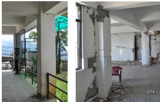
(b) 一层框架柱震损
