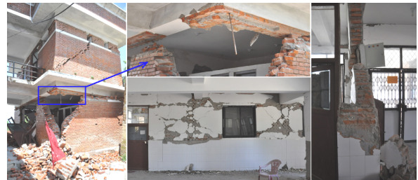
(e) 一层填充墙严重破坏, 局部倒塌
