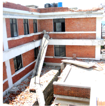
(f) 女儿墙及顶梁无拉结, 整体掉落
