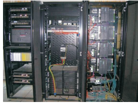
图 2 现场 DCS 设备
