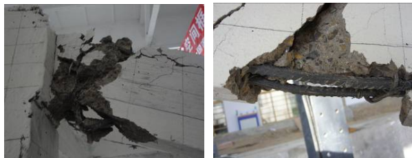
图 10 梁铰破坏状态
