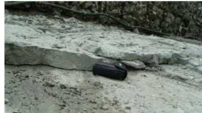
图2-29 云南小湾水电站坝基开挖过程中建基面岩体中出现的板裂现象
