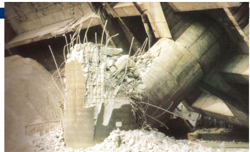
桥梁钢筋混凝土墩的剪切破坏
