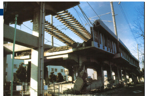
由于柱的剪切破坏引起的铁路框架桥的坍塌
