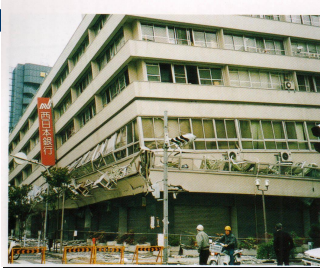
槽形钢骨钢筋混凝土建筑结构中间层 (第二层)的破坏
