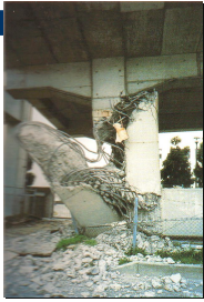
铁路钢筋混凝土框架 高架桥的剪切破坏
