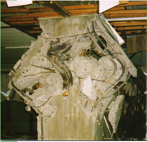
剪压破坏的槽形钢骨 钢筋混凝土柱
