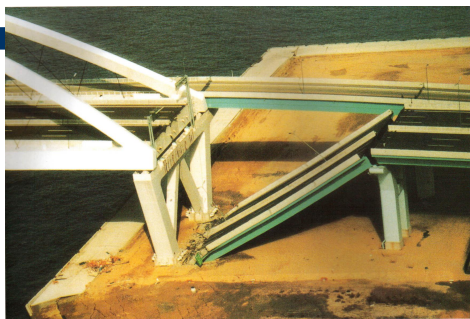
日本Nishinomiya 港口桥震落的桥跨
