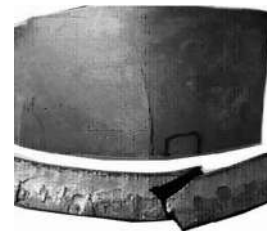
图1 焊管开裂形貌
