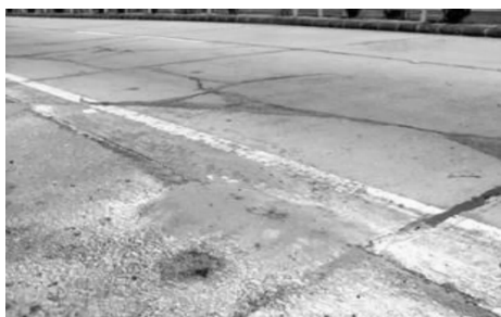
图1 某部车炮库路面断裂带
