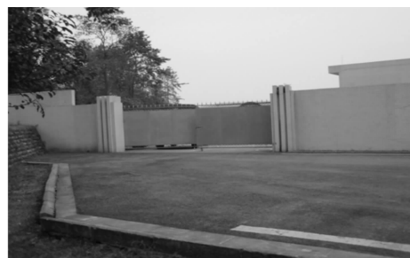
图3 某部车炮库出入口与道路衔接不当
