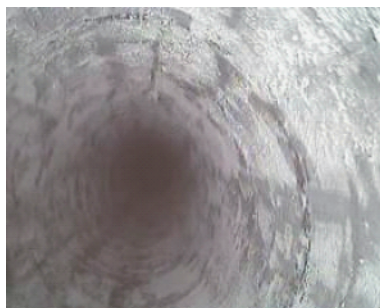
(b) 顶板 1990mm 环向裂隙 (b) Ring fissure roof 1990mm
