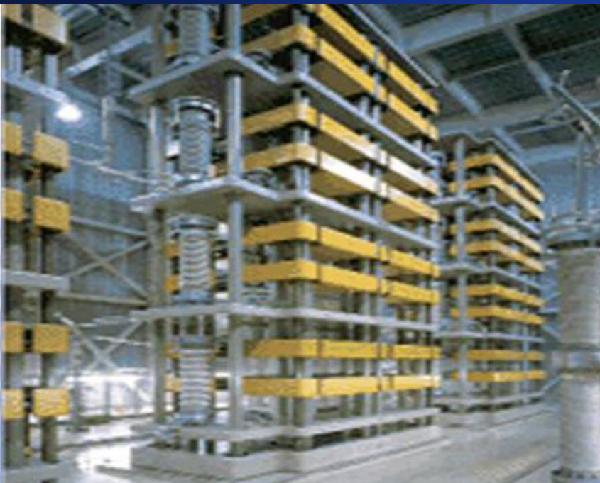
高压直流 (HVDC)
