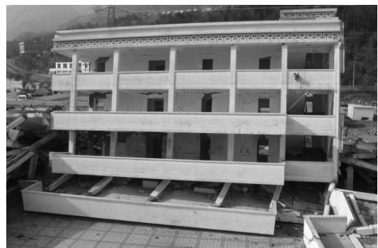
图 4 教学楼 C 的震害照片
