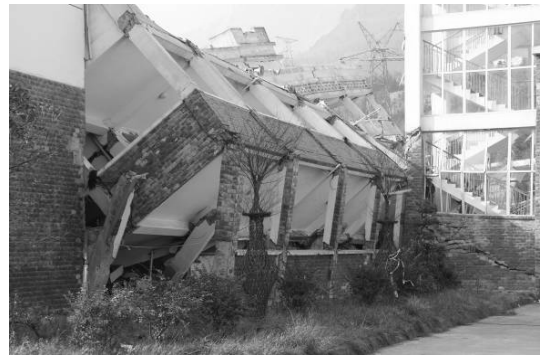
(a) 北面中央楼梯间东侧走廊倒塌破坏
