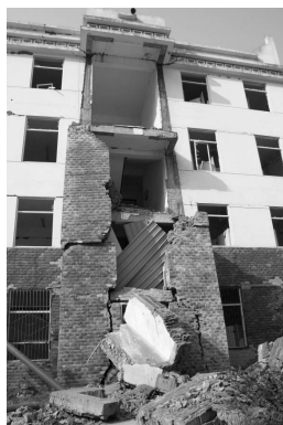
(b) 入口门厅填充墙破坏
