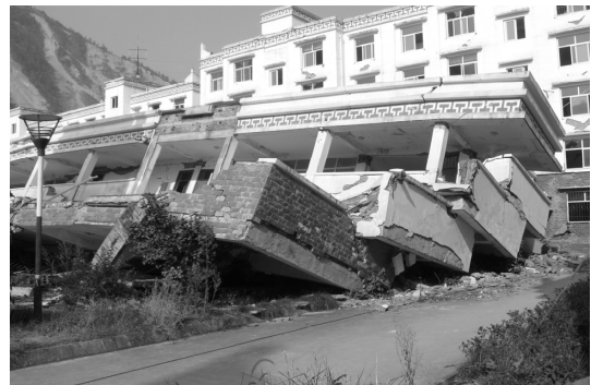
图 3 教学楼 B 的震害照片
