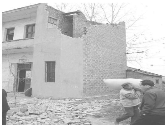
图 8 房屋 2层楼梯间倒塌
