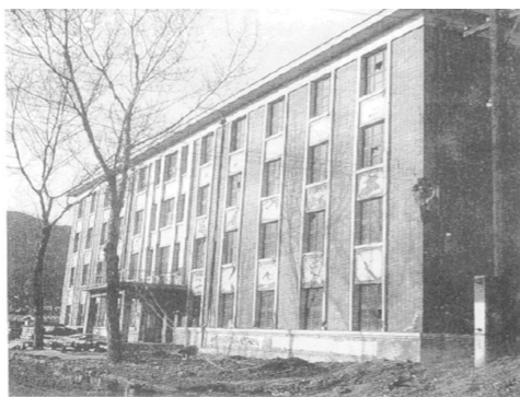
图 2 1976年唐山地震中建筑陶瓷厂办公楼窗肚墙出现 塑性铰 [2]
