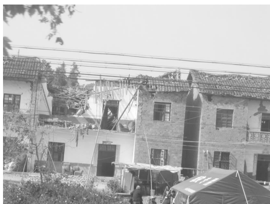
图 7 房屋 2层木屋架屋顶倒塌
