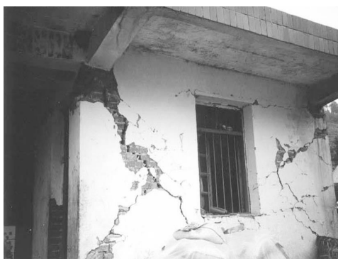
图 4 2003年云南大姚地震中砖墙房屋墙体严重开裂(葛学礼)
