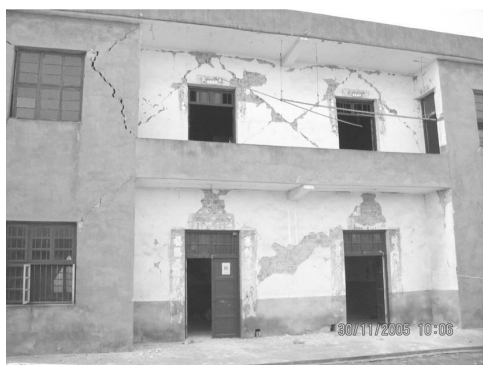
图 3 九江地震中民宅产生斜裂缝和 X 形裂缝
