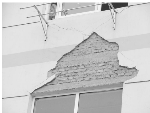
图 1 瑞昌市一中学生宿舍楼窗肚墙出现 X 裂缝(葛学礼)
