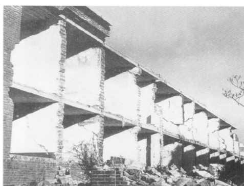
图 6 1976年唐山地震中铁路楼南侧纵墙开厢 [2]
