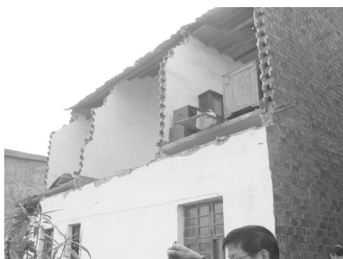
图 5 港口街镇洗心桥村一民宅 2层外纵墙外闪倒塌
