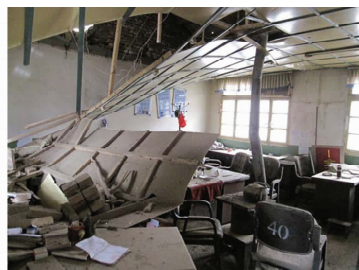
图 13 教学楼吊顶坠落
