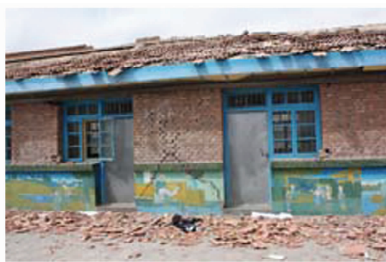
图 12 窗间墙破坏和屋顶溜瓦
