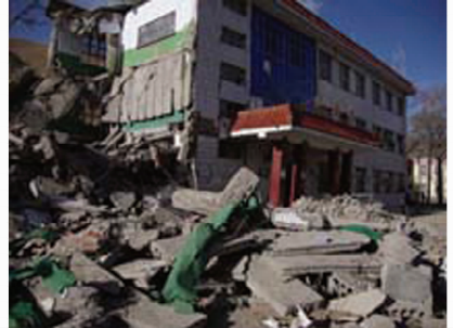
图 8 3 层电教楼局部倒塌(预制板)
