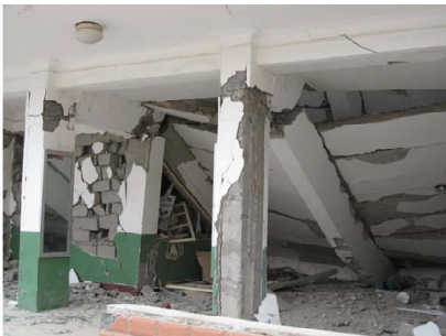
图 9 3 层教学楼楼梯破坏
