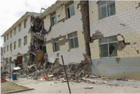
图 7 3 层宿舍底层坍塌
