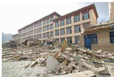
图 11 1层教学楼倒塌
