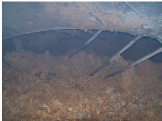
图8 K1+322处塌方 Fig. 8 The collapse of K1+322
