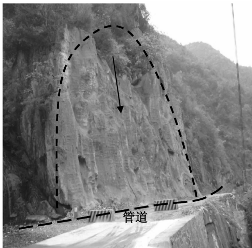
图 1 管道经过康县崩塌区
