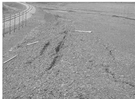
图 6 冻土边坡滑塌
