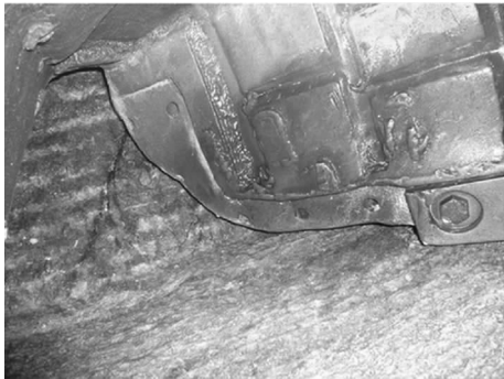
(b) 1,2号刮刀座严重磨损变形
