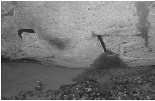
(a) 磨损和变形
