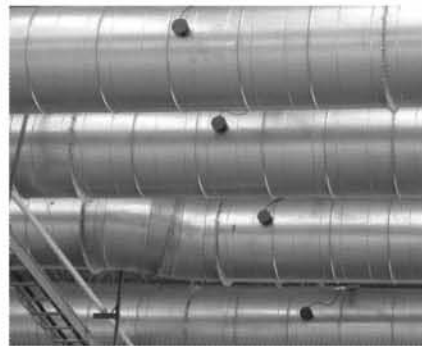
图3 应用于水平管道阵列的火花检测器 Fig.3 Spark detector applied in horizontal pipe
