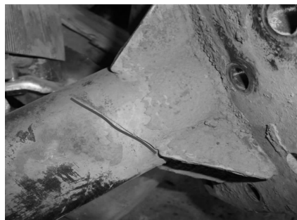
图2 实物实际断裂处
