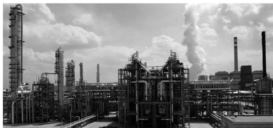
图 4 神华包头煤制烯烃示范工程装置
