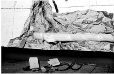
(b) GFRP 筋断裂
