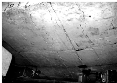
(a) 板底贯穿裂缝
