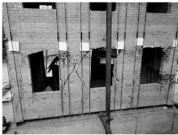
图 13 ①轴窗间墙 X 形裂缝
