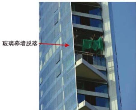
图 15 Titanium Tower 玻璃幕墙的破坏 [2]
