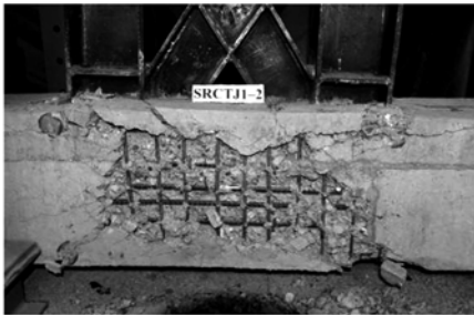
图11 SRCTJ1-2 节点区混凝土压溃
